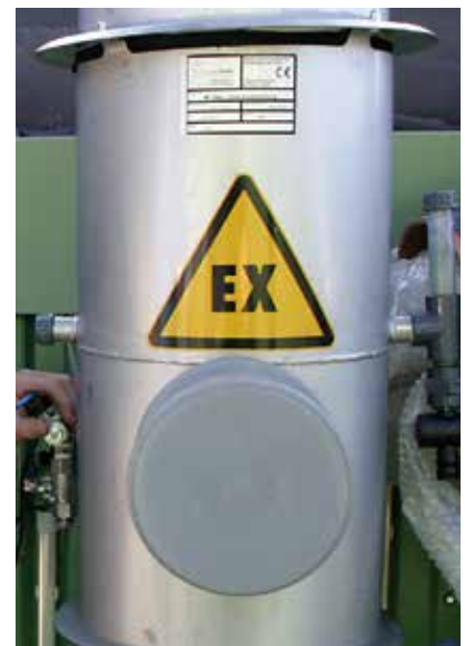
Biogasanlagen unterliegen aufgrund der explosionsgeschützten Anlagenteile der Betriebssicherheitsverordnung
